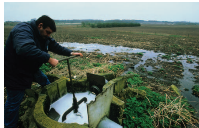
Plaine de Méry-Pierrelaye. Ouverture d'une bouche d'irrigation. 2002.
